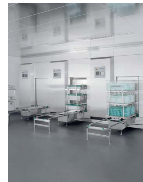
Installation mit drei 6 STE-Dampfsterilisatoren mit automatischer Beladung und Schleuse.
