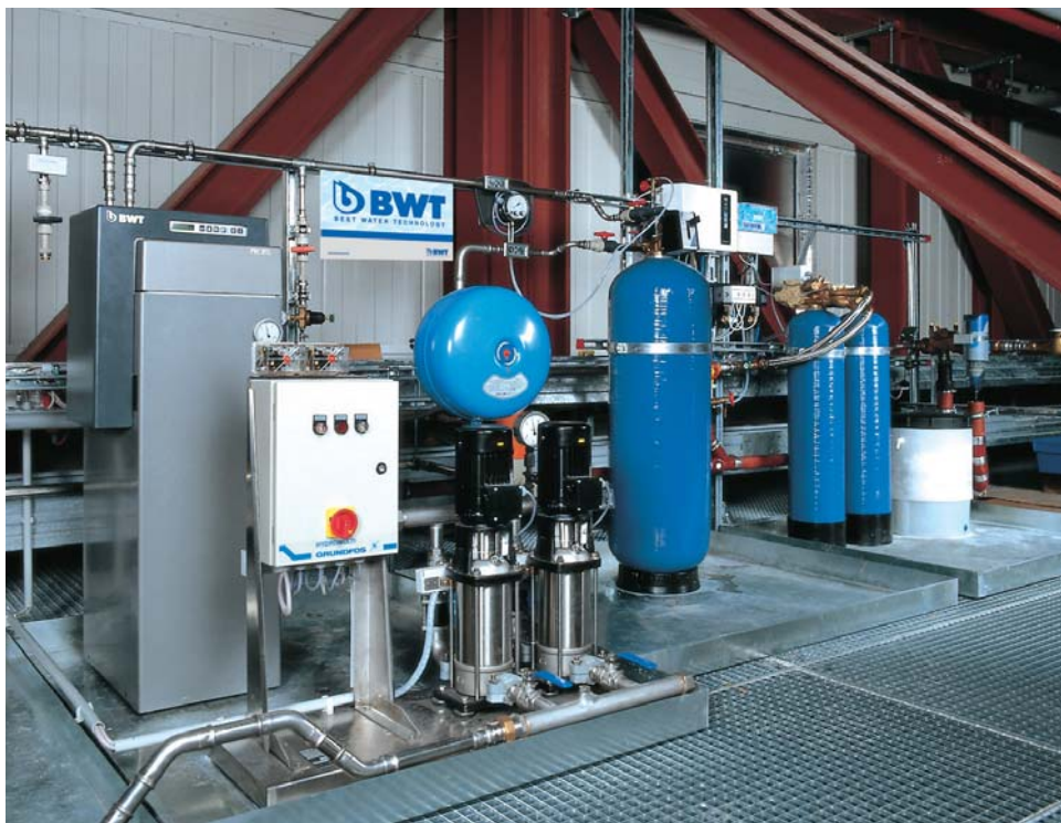
Wasseraufbereitung für Klima-Luftwäscher.
